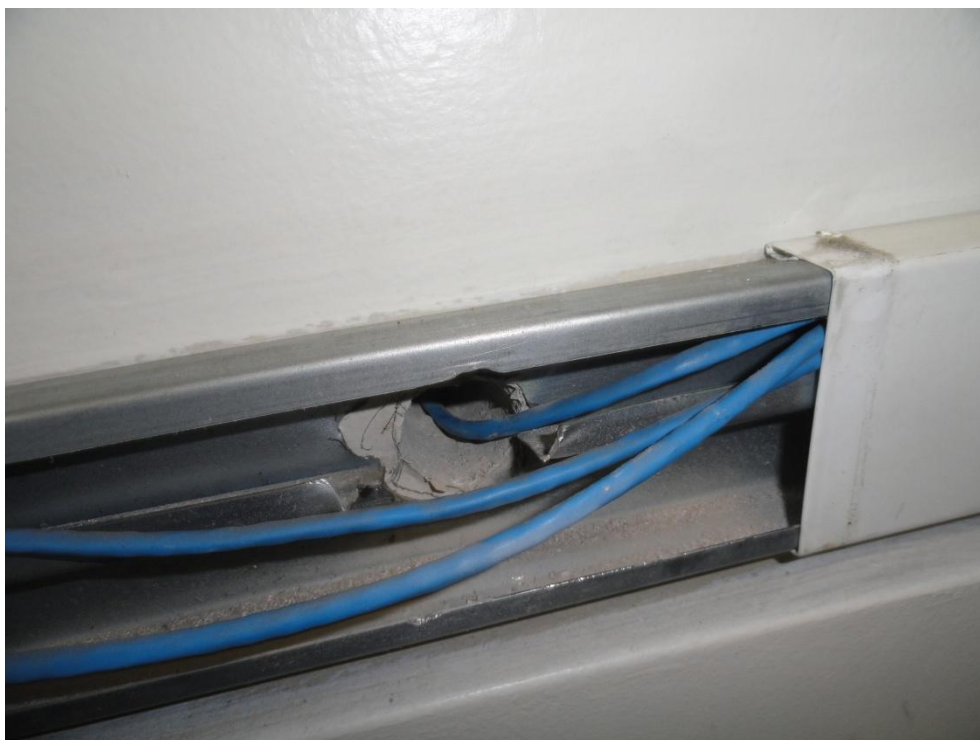
Foto 07 –Passagem de cabos para sala ao lado.
