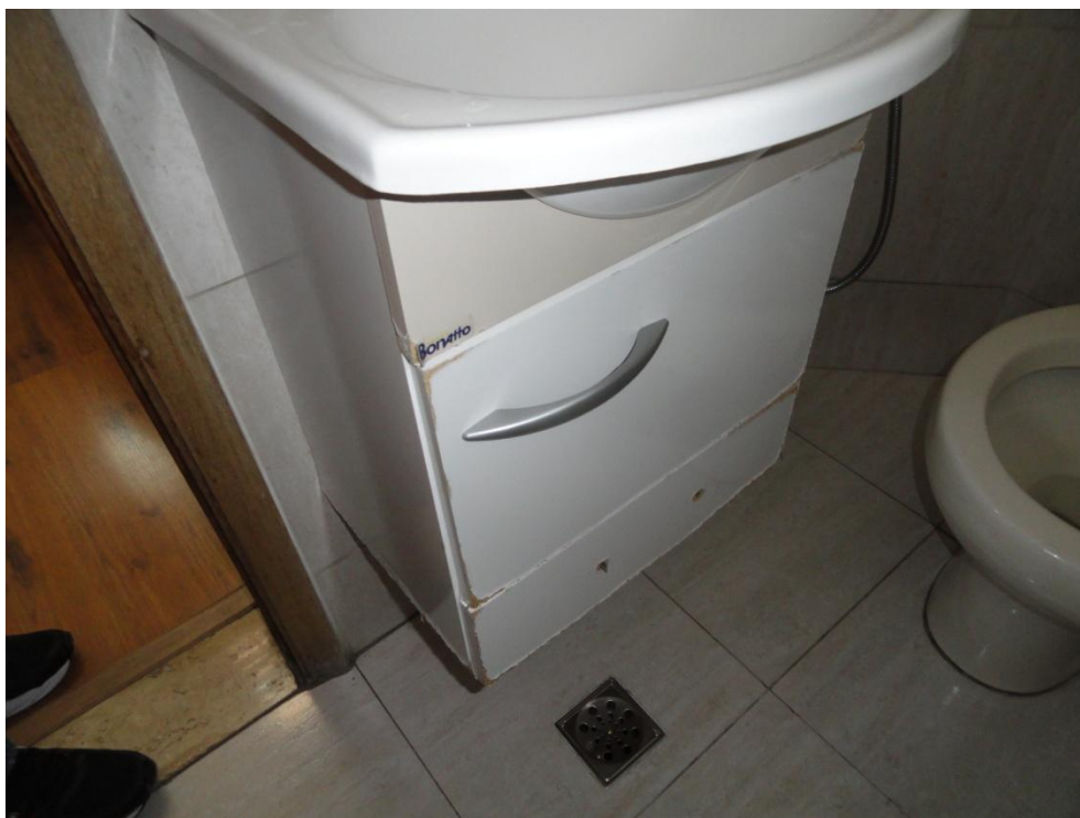
Foto 08 – Gabinete a ser substituído.
