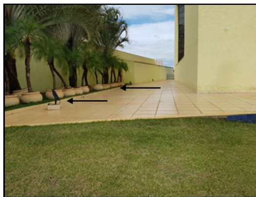
Foto 16 – Foto ilustrativa de guia em alvenaria a ser removida
