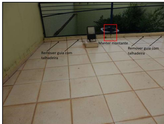
Foto 06 – Foto ilustrativa de trecho de guia a ser removida
