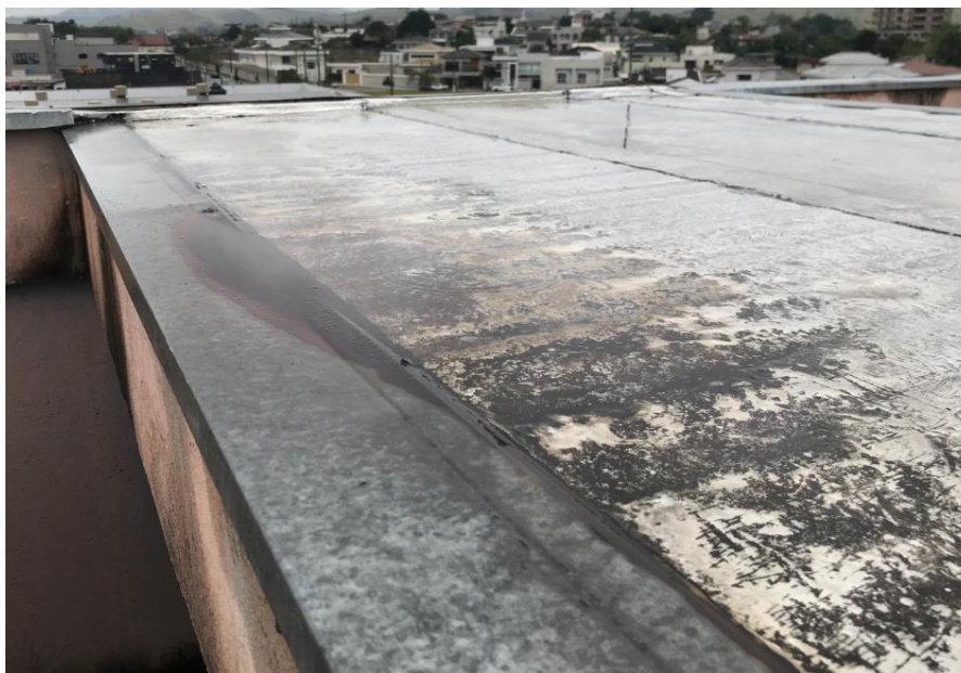
Imagens 16 – Ruffo e impermeabilização a serem substituídos na laje de cobertura da casa de máquinas.
