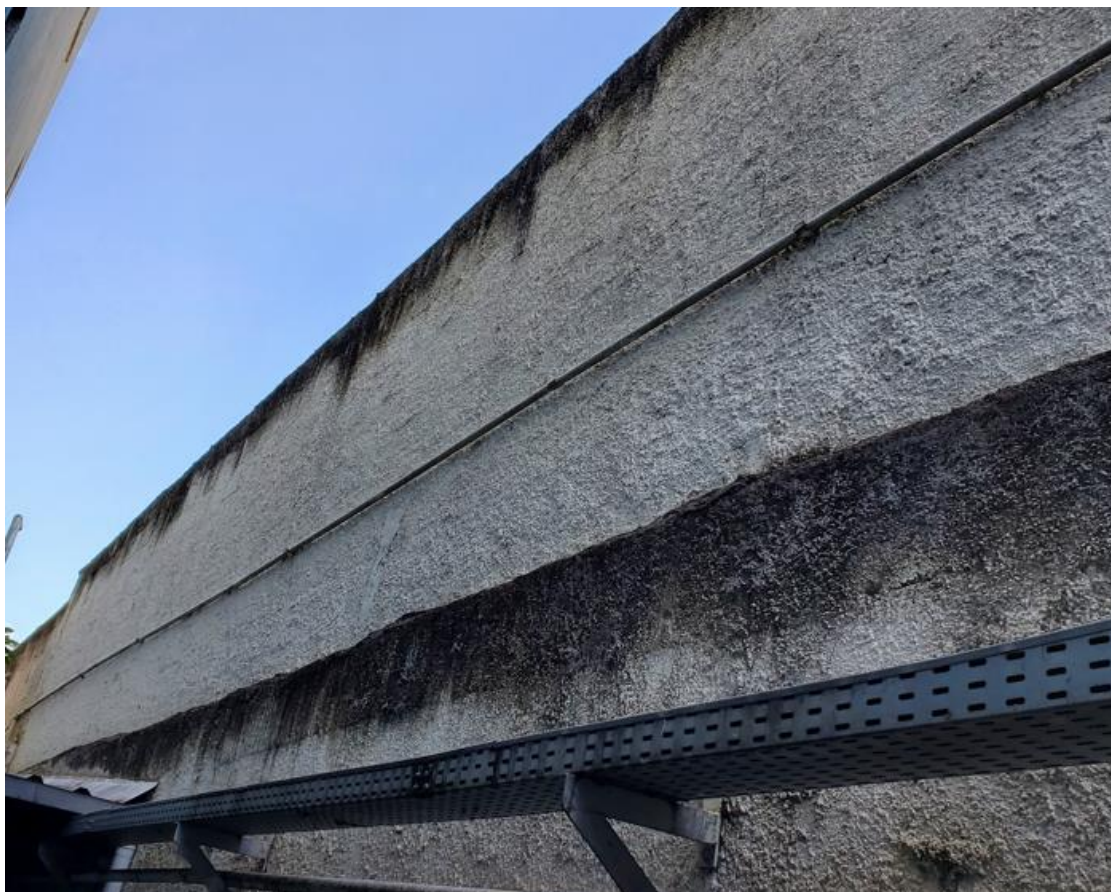
Imagem 4 – Visão de parte do muro do térreo (acima) e muro do subsolo (abaixo), nos quais deverá ser realizada a instalação dos rufos.
