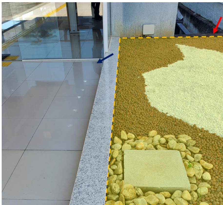
Imagem 6 – Parte da jardineira que terá a impermeabilização refeita (em amarelo), um dos locais de instalação do rufo e do guarda-corpo (seta vermelha) e local de instalação da soleira (seta azul escuro).
