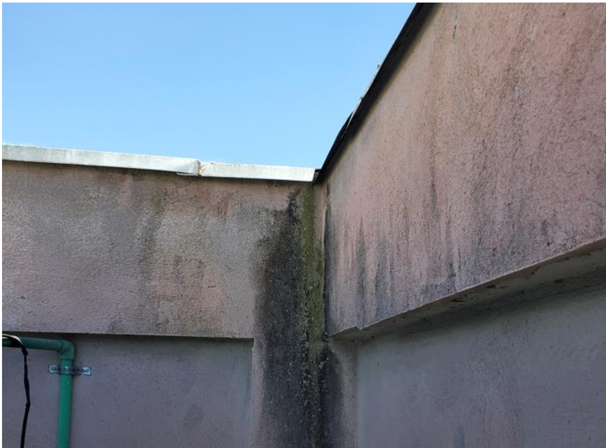
Imagem 3 – Visão de parte do muro do rufo a ser removido na cobertura.
