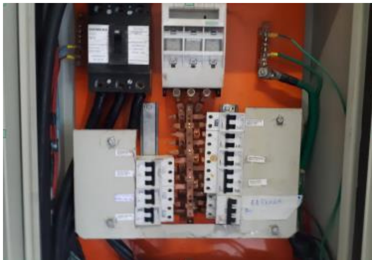
Foto 6 – QDE a ser reformado.
