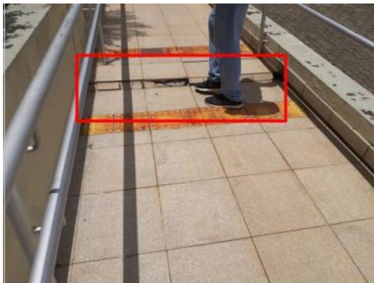
Foto 1 – Área da rampa prejudicada.
