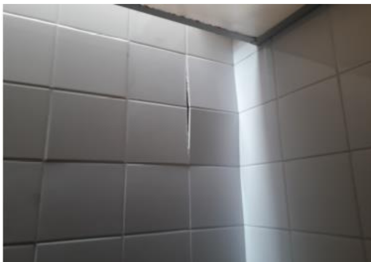
Foto 3 – Azulejo com assentamento prejudicado.
