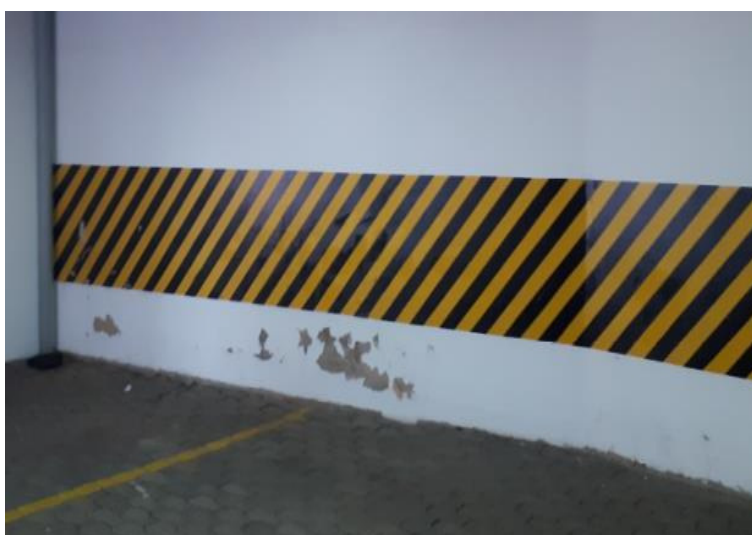
Foto 15 – Sinalização “zebrada” a ser “reforçada”.
