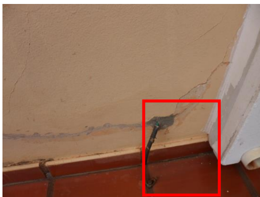
Foto 4 – Barra de aterramento;
