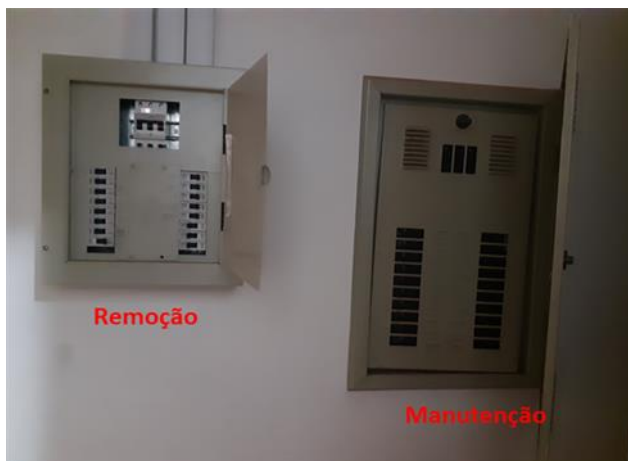
Foto 2 – Quadros de Distribuição (QD)
