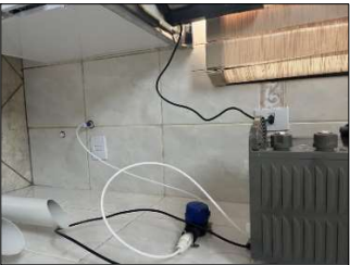
IMAGEM DA TUBULAÇÃO DO FILTRO
