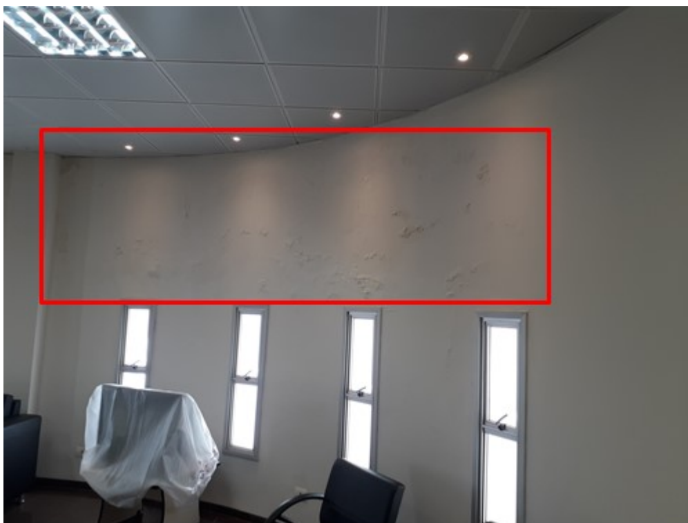
Foto 1 – Destacamento da pintura – gabinete da direção. Face junto à rua Dr. Euclides da Cunha Viana.
