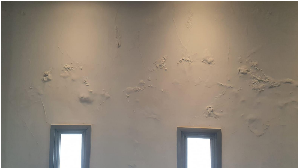
Foto nº 2:- Sala da Diretoria no 2º piso. Revestimento seco, porem o reboco está firme na parede, mas com qualidade duvidosa.
