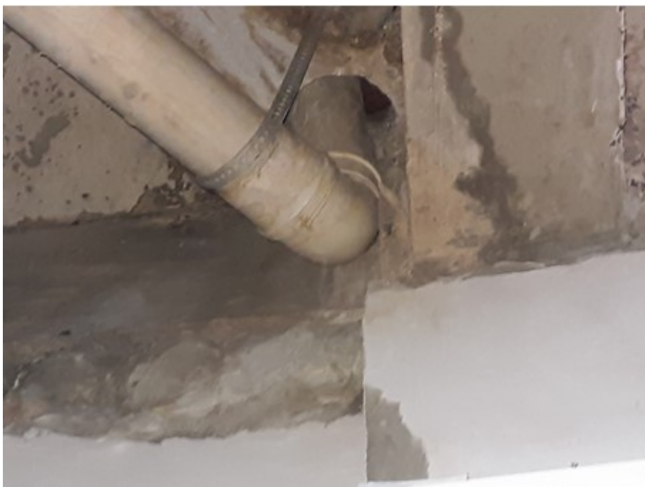
Foto 6 – Local da percolação de água – hall do auditório.
