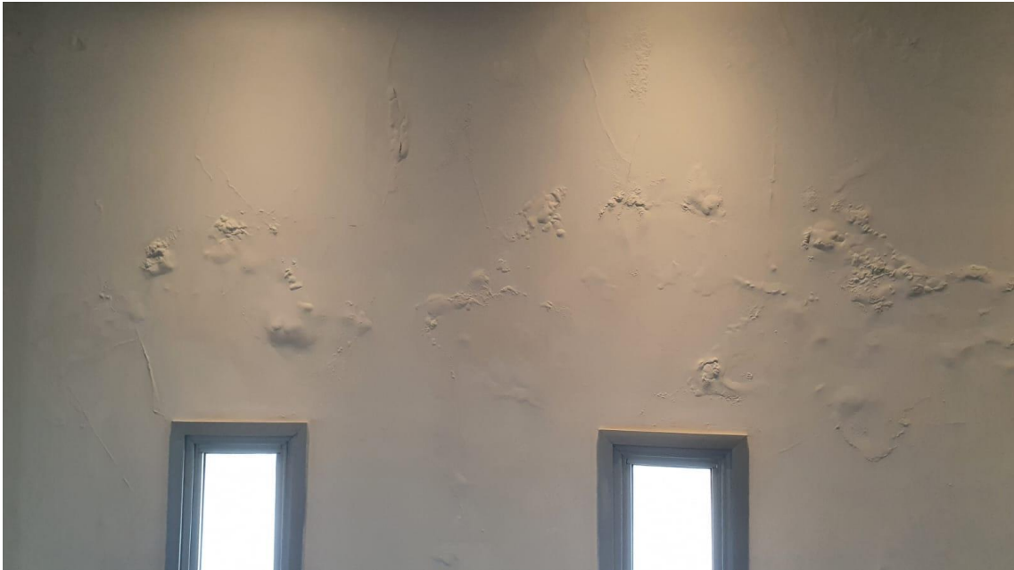
Foto nº 2:- Sala da Diretoria no 2º piso. Revestimento seco, porem o reboco está firme na parede, mas com qualidade duvidosa.
