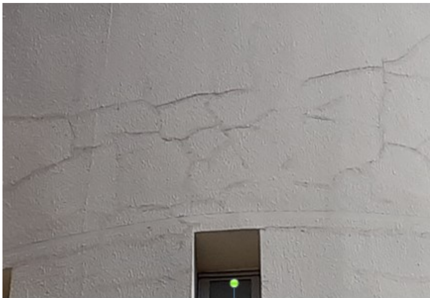
Foto 5 – Detalhe da foto 4 – Situação do emboço/reboco.
