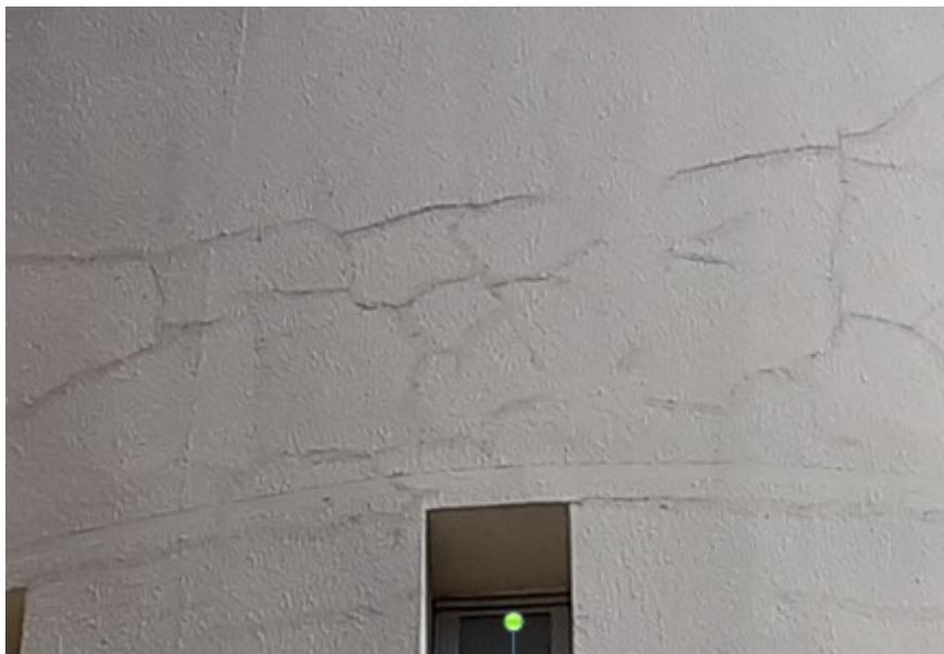
Foto 5 – Detalhe da foto 4 – Situação do emboço/reboco.
