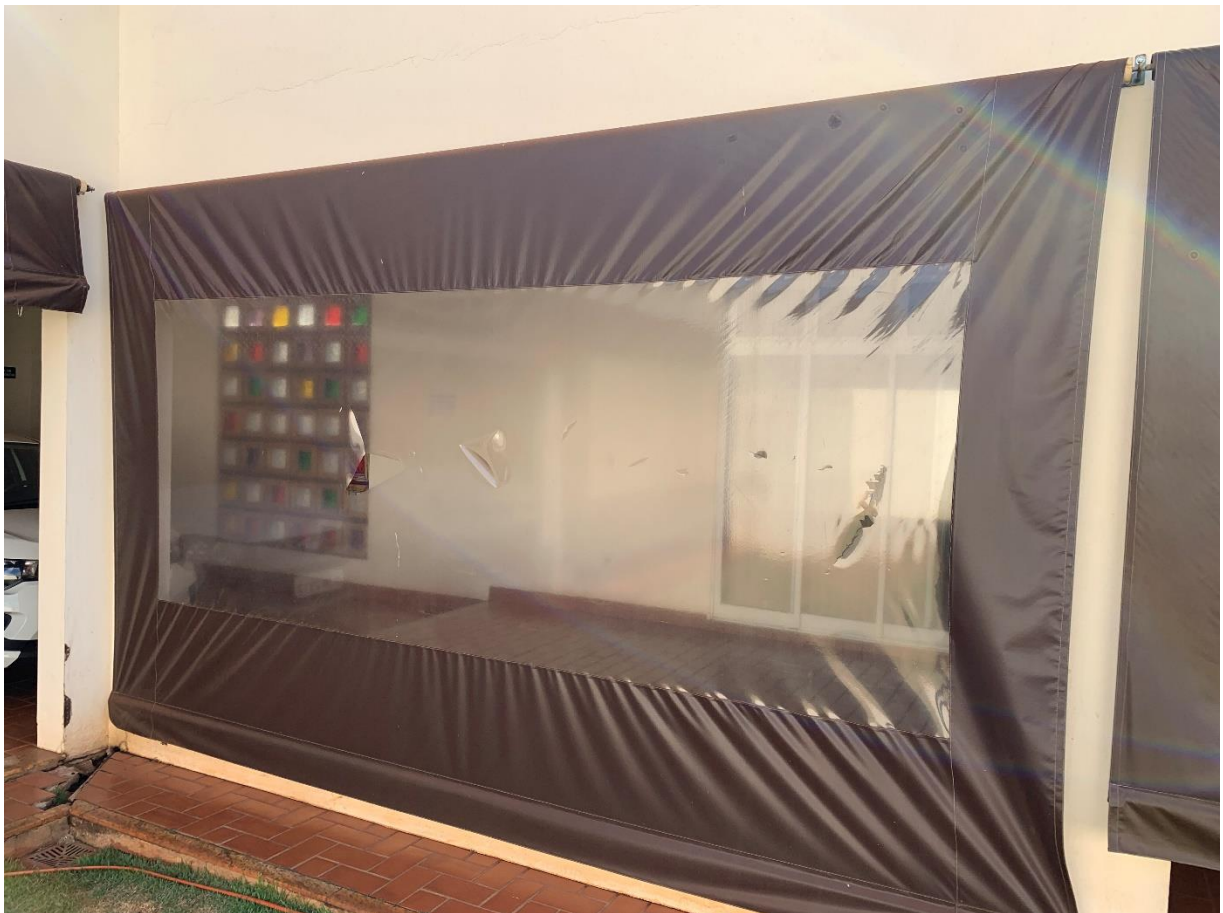
Visor rasgado – precisa de manutenção, será feito novo toldo conforme modelo acima.
