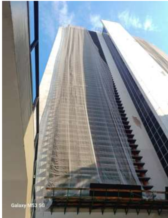
Foto 1 – Situação dos dispositivos de segurança instalados na fachada posterior do prédio Sede do TCESP. Registro fotográfico em 24.10.24.
