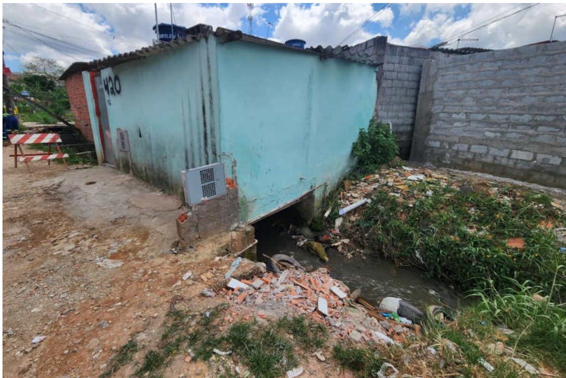
Figura 34 - Residência construída sobre córrego na etapa 3
