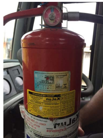
Guarujá - extintores com prazo de recarga vencido
