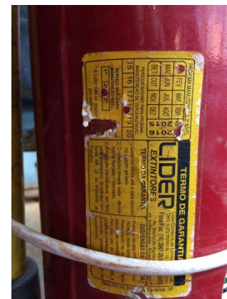
Batatais - extintores com prazo de recarga vencido
