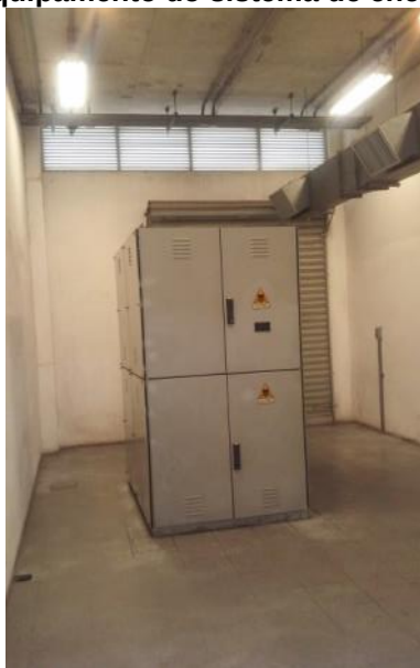
Sala estação Itaim Paulista com equipamento do sistema de energia
