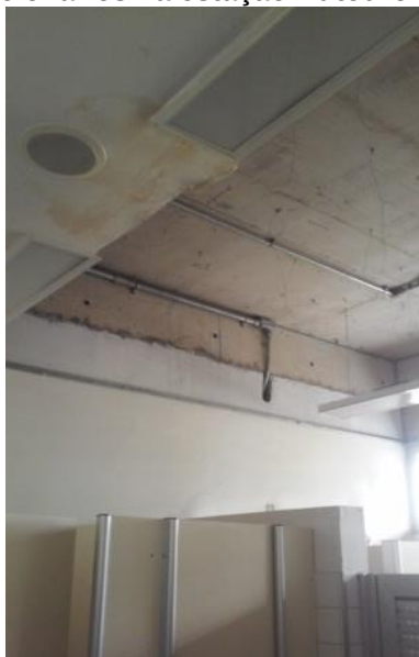
Forro danificado em vestiário de funcionários na estação Autódromo
