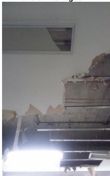
Forro danificado na estação Primavera-Interlagos
