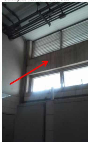
Janelas com infiltração da estação Itaim Paulista
