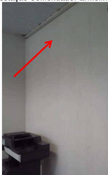
Sala com infiltração na estação Comendador Ermelino
