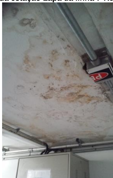
Infiltração em área operacional da estação Lapa da linha 7-Rubi
