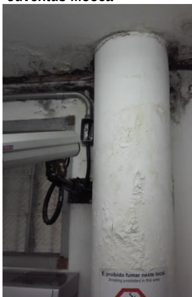
Infiltração e mofo na estação Juventus-Mooca
