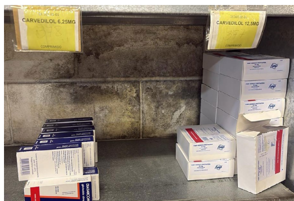
Entre problemas encontrados pelos técnicos do TCEsp, paredes com mofo e evidências de má conservação dos remédios
